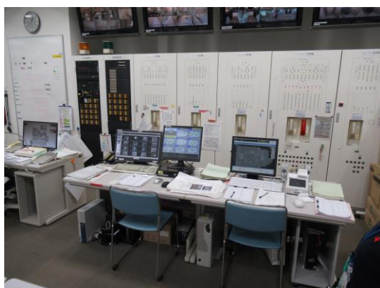
防災センターエレベーターシステム
